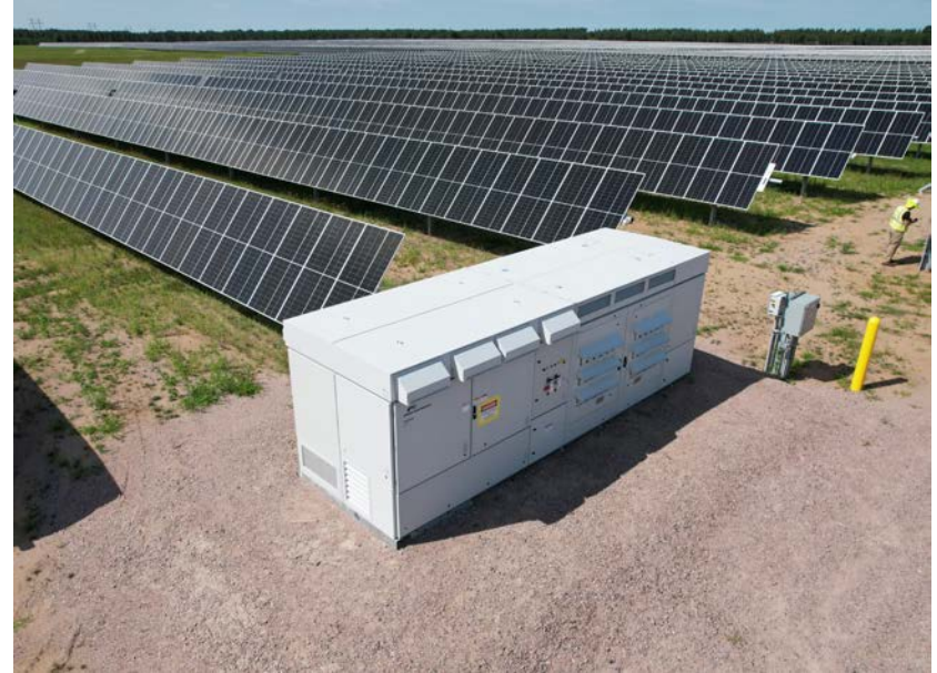
4,010 KVA inverter (July 2022)
